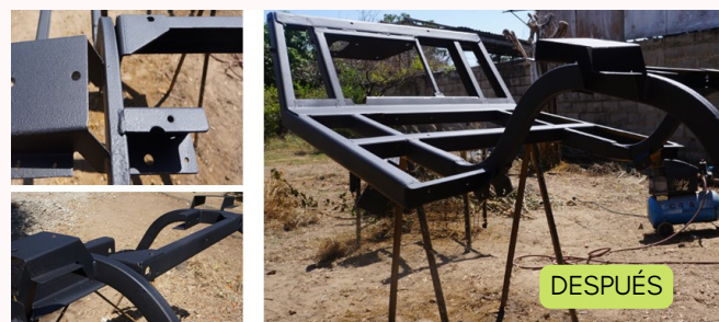
Reconstruido en lámina estructural de alta resistencia. Se aplicó recubrimiento protector ANTICORROSIVO diseñado para estructuras expuestas a lluvias e intemperie.
