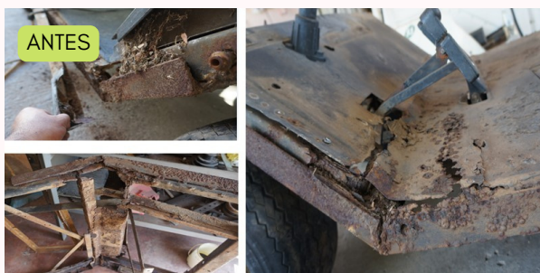
Elevado grado de corrosión en la estructura
